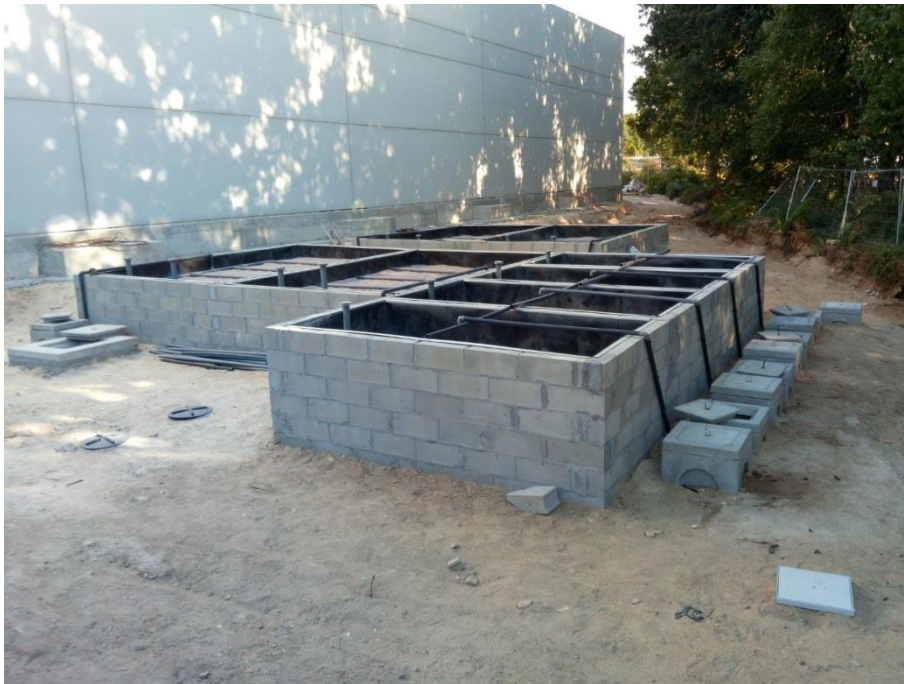
Foto 2: Balsas de humedales de la planta integral VARAL.
