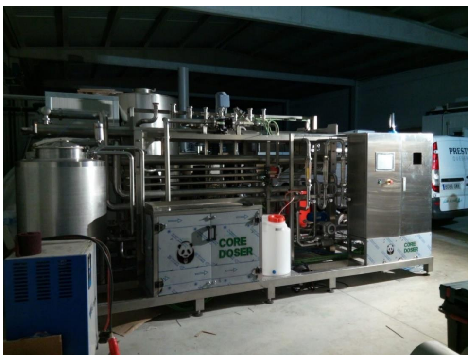
Figura 2: Máquina de nanofiltración de la planta integral VARAL.
